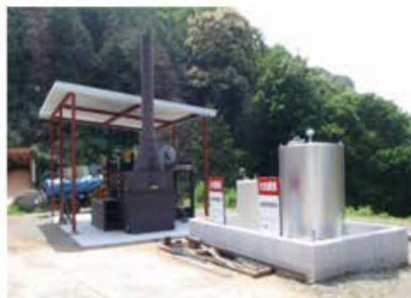
写真は上部投入・台車投入型 CAB型 写真手前は、燃料供給装置
