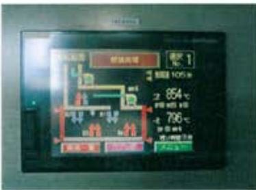
動作監視画面 温度監視・機器動作監視
