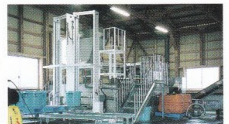
▲平成15年3月納入 JA愛媛たいき 内子堆肥センター
